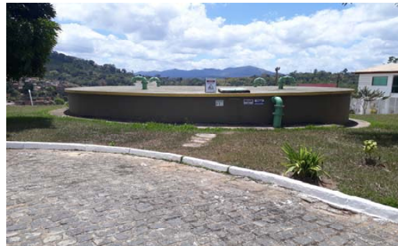
Foto 06: Reservatório de Distribuição – ETA.
