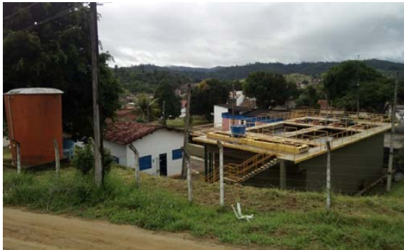
Foto 03: Unidades Operacionais – ETA.
