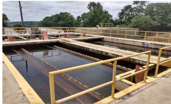
Foto 04: Unidades Operacionais – ETA.
